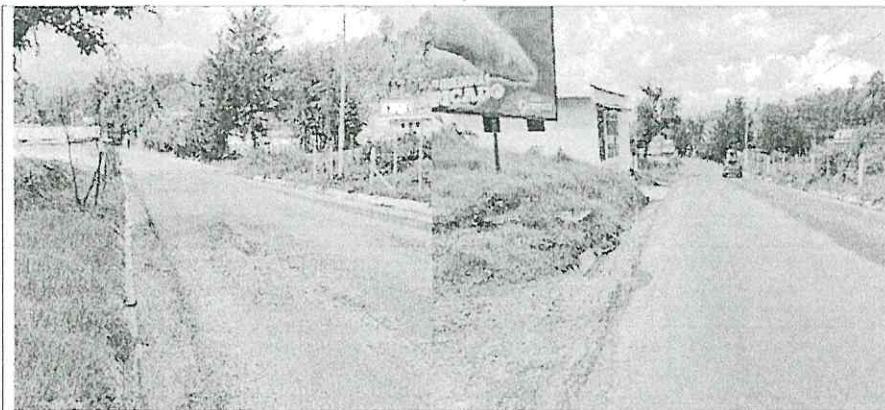
Trabajos realizados en la carpeta de rodadura, la misma se encuentra deteriorada con baches de distintos tamaños y profundidades.
