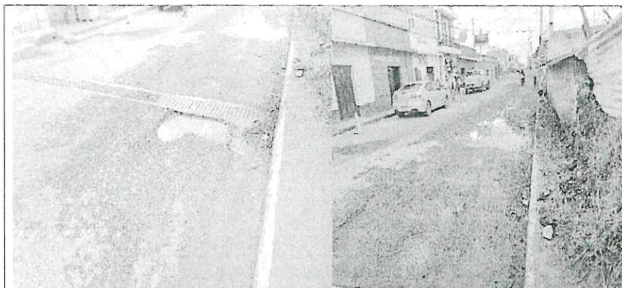
Trabajos realizados en la carpeta de rodadura, la misma se encuentra deteriorada con baches de distintos tamaños y profundidades. Las fotografías muestran la cabecera municipal de San Pedro Jocopilas.
