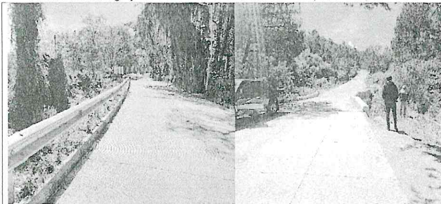
Trabajos realizados en la carpeta de rodadura de concreto hidráulico y cunetas de concreto laterales, los trabajos ejecutados se encuentran en condiciones aceptables.
