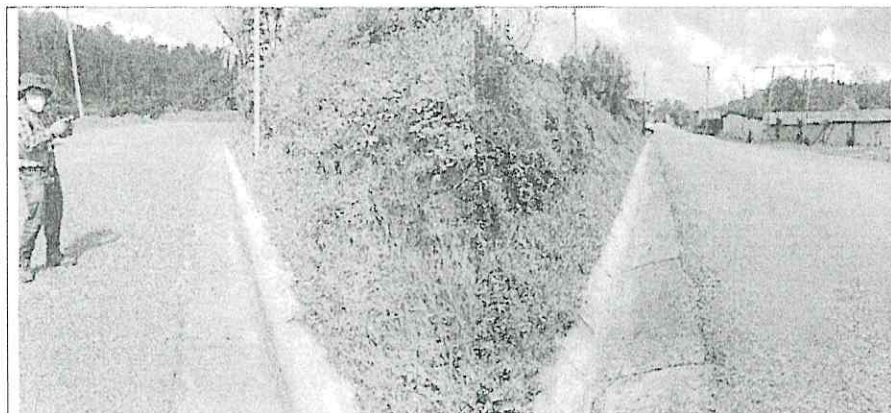
Trabajos realizados en la carpeta de rodadura y cunetas de concreto laterales, los trabajos ejecutados se encuentran en condiciones aceptables.
